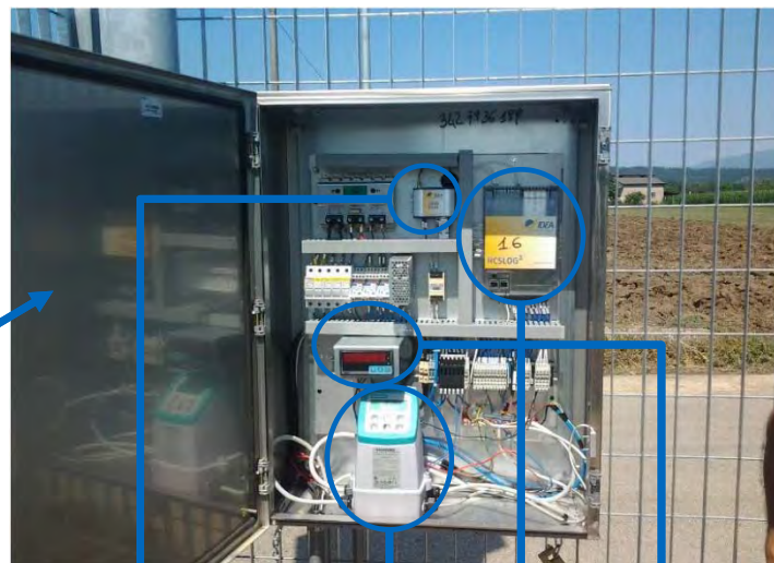
Quadro telecontrollo componenti principali
